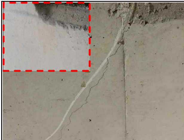
교각 균열(폭 0.2mm)(보수완료)
