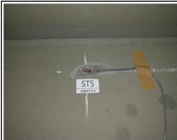
변형률계 설치 현황
