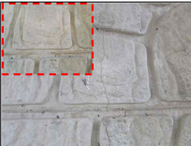
교대 A1 전면벽체 균열(폭 0.3mm이상)(보수완료)
